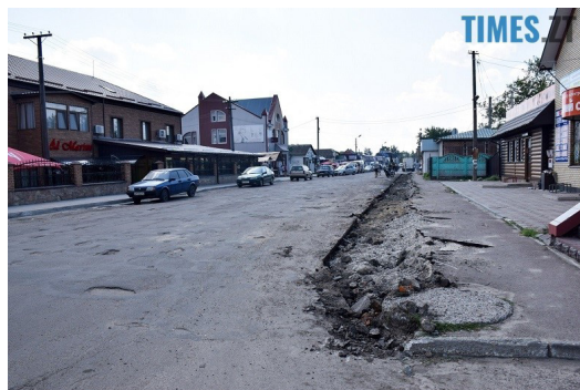
Олевськ, вулиця Київська до ремонту
